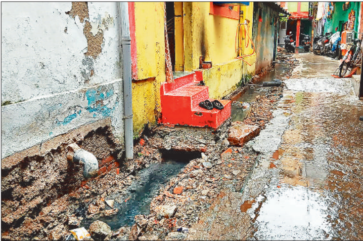
तेलीपारा दरबार लॉज के पीछे अधूरा निर्माण।
